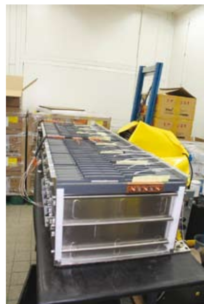
Batterie des E-Truck (Foto: Hintzen Logistik)
